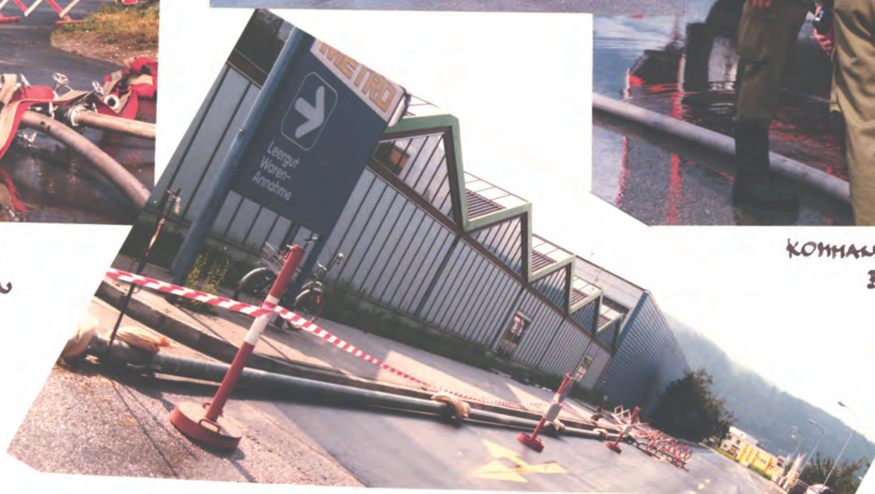
VERSORGUNGSLEITUNG IN RUH
